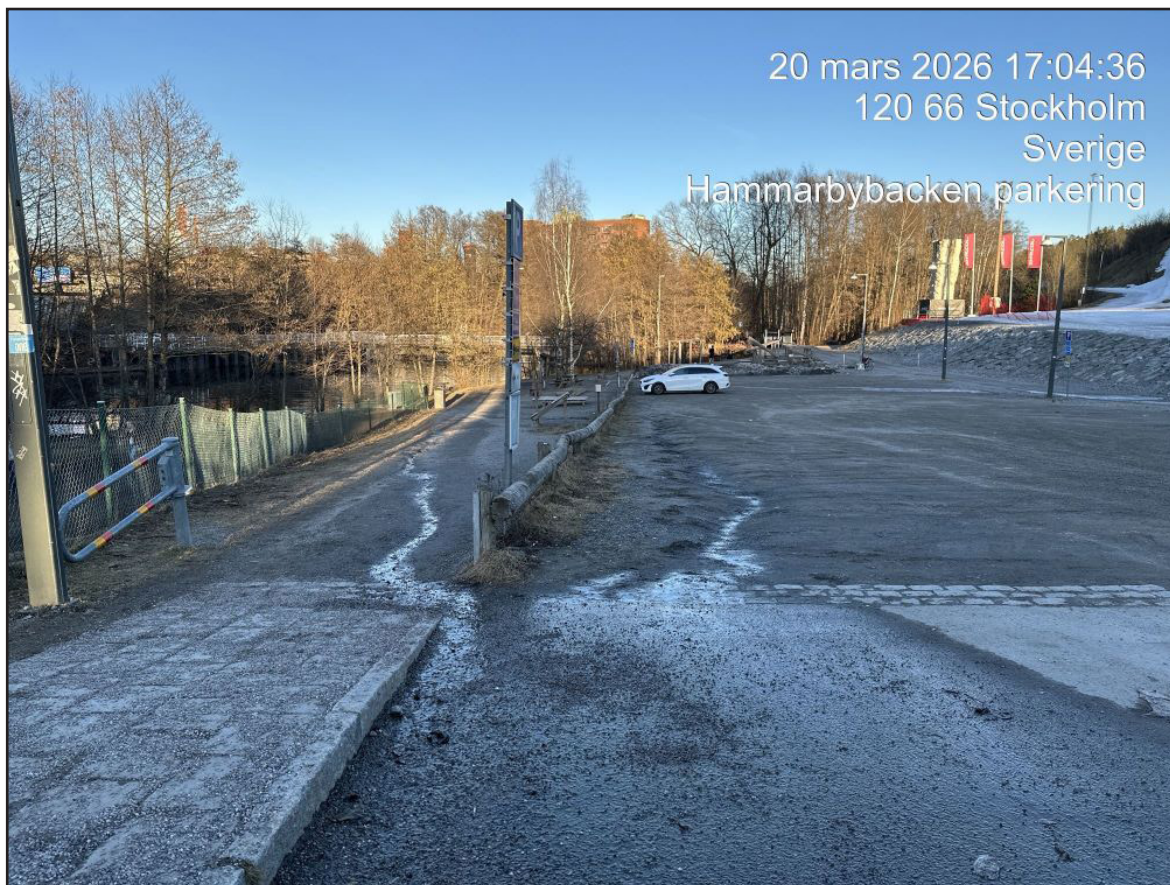
Smält- och regnvatten från parkeringsytans västra delar skapar fåror i gångbanan och på parkeringsytan.
