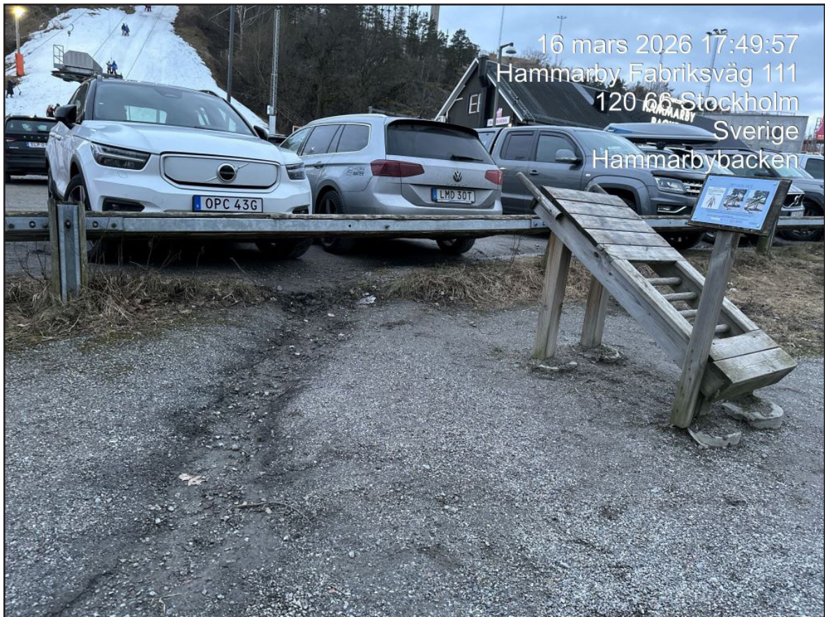
Smält- och regnvatten som rinner ut från parkeringsytan skapar fåror i gångbanan. Utegymmets fundament blottläggs när gruset försvinner.
