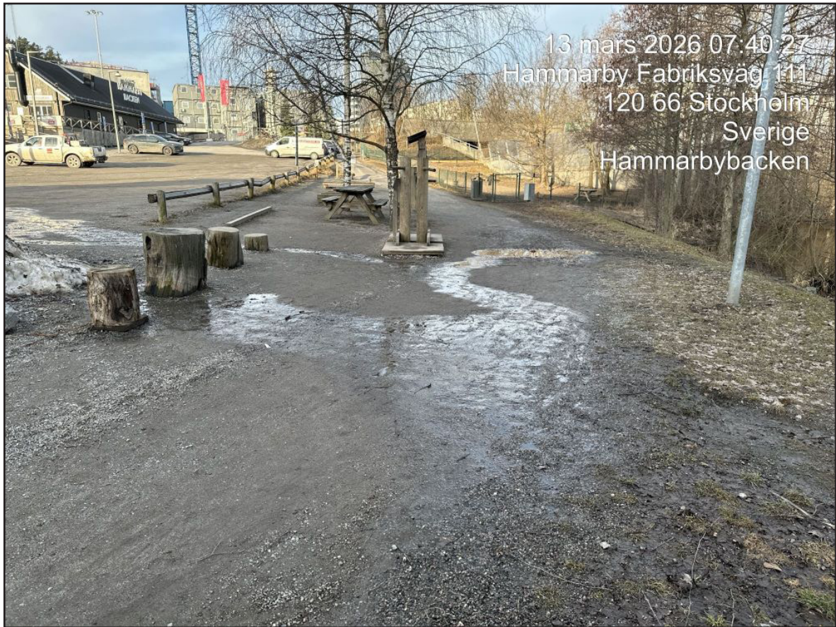
Smältvattnet på föregående sida bildar en blöt, kladdig och vid minusgrader halkig yta, över gångvägen norr om parkeringsplatsen. Gångvägen utsätts för erotering och utegymmets fundament blottläggs.
