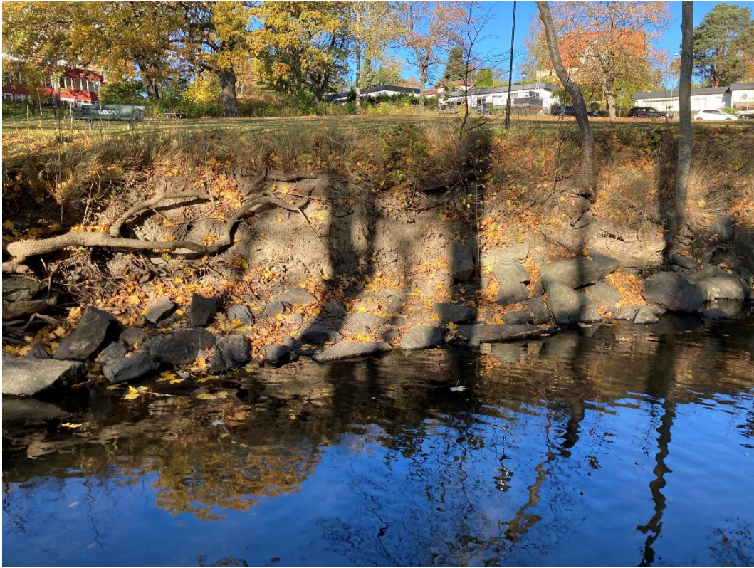
Figur 11. Kraftig erosion längs vattendragsfårans kant vid sjöutloppet.
