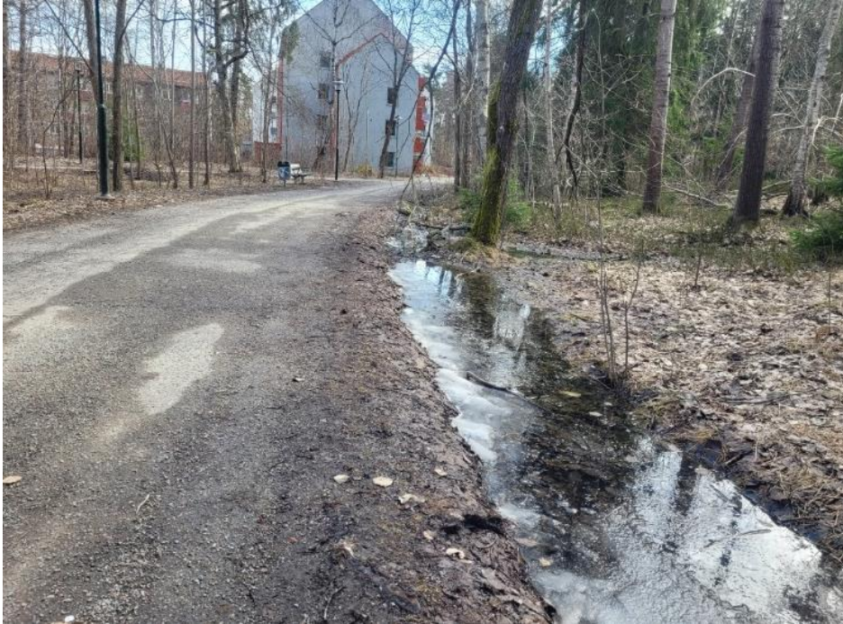
Figur 4. Stående vatten längs vägen. Projekt- SHP 2023.
