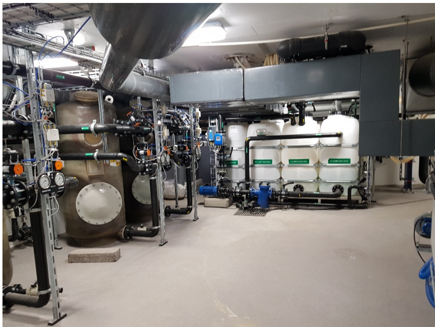
Bild av ny vattenreningsanläggning
