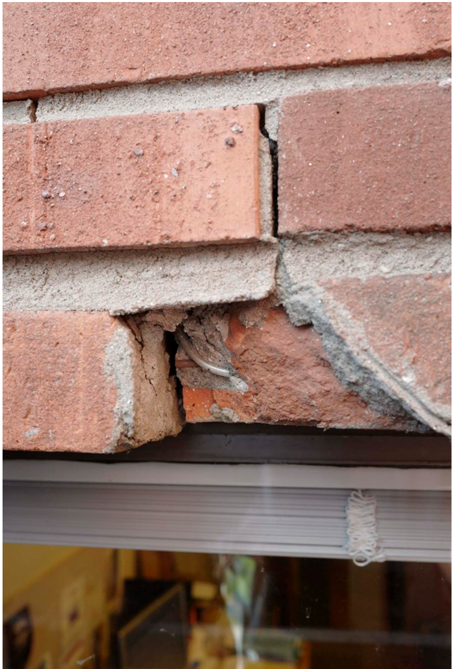
Bilden visar en tegelbalk som sjunkit. Resultatet blir bland annat fogsprickor, korrosion och frostsprängning
