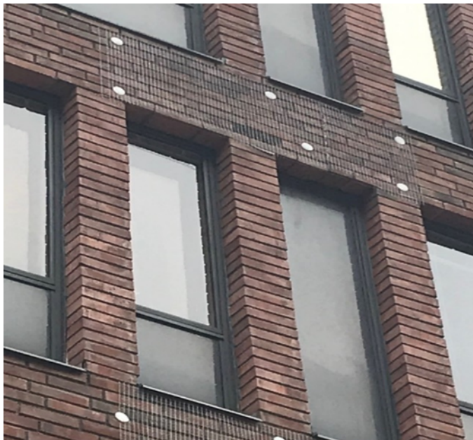
Figur 2: Fasaden har nätats för att förhindra nedfallande tegelstenar
