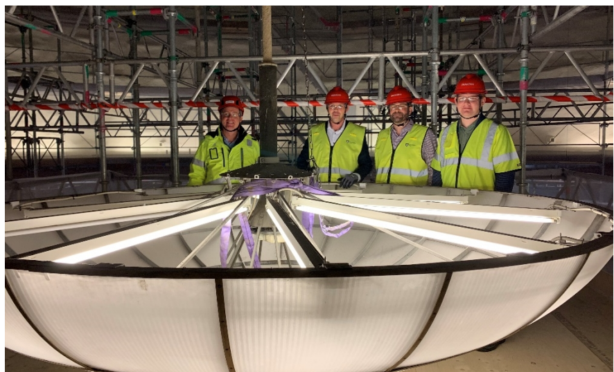
Figur 1. I bokhallen/rotundans takkrona innan glaset togs ner för renovering. Fr v Bengt Staaff, Anders Kindberg, Jonas Naddebo och Dennis Wedin.
