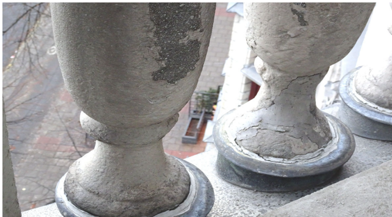
Ytterligare exempel på skador på fasadsten. Foto Renovum AB
