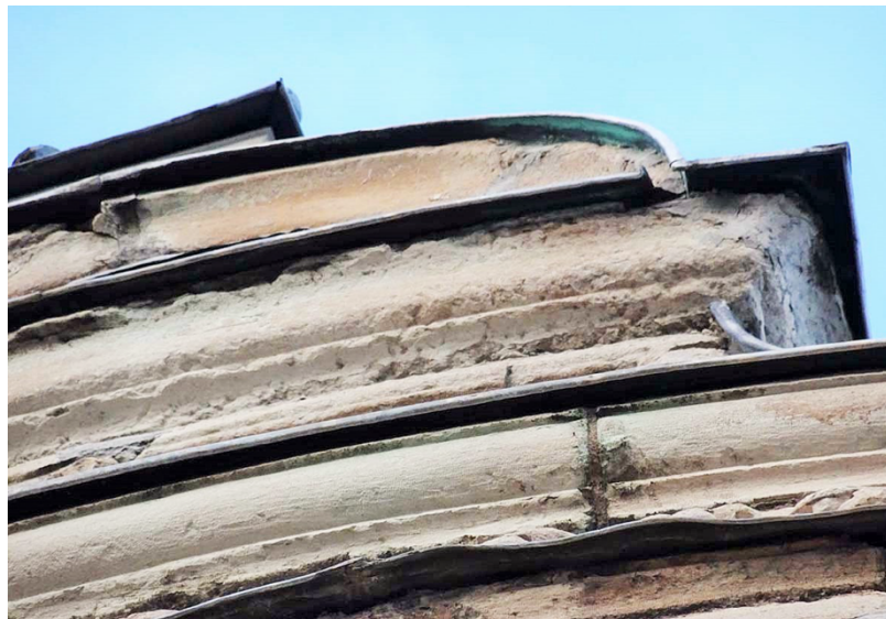
Exempel på skador på fasadsten. Foto Renovum AB
