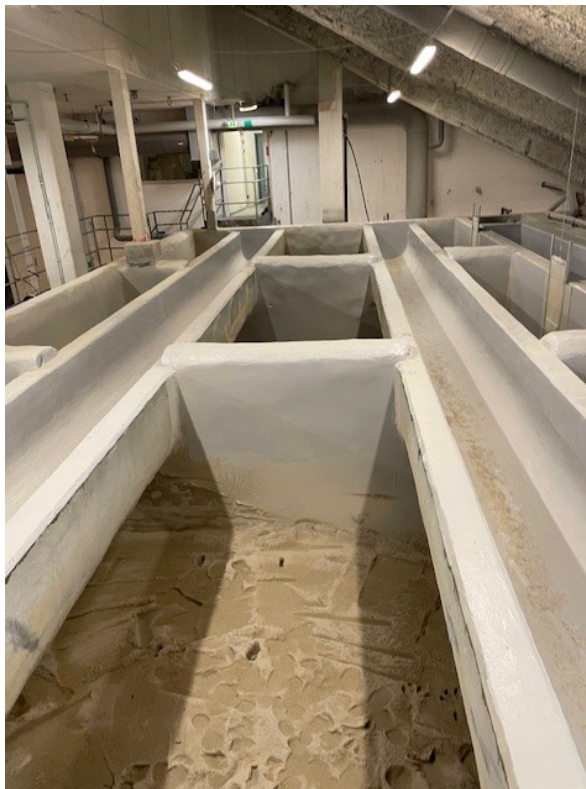
Sandfilterbassänger för rening av vatten efter reovering.
