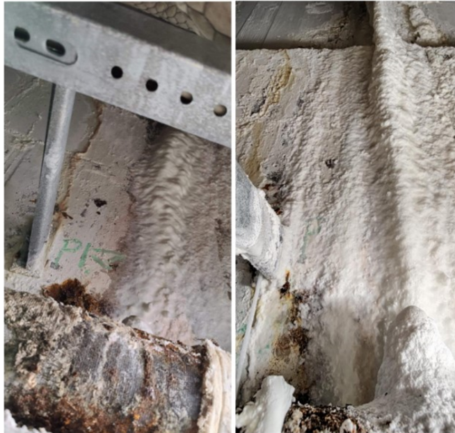
Källa: Skadeutredning Äventyrsbad WSP 2024-09-10
