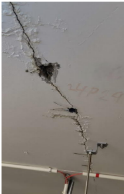
Provtagning 24P29. Provtagning mitt i krympspricka för ramp. Källa: Skadeutredning garage WSP 2024-09-10
