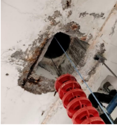
Figur 3, spjälkad och blottad armering vid genomföring för lindrag. Källa: Skadeutredning tävlingsbassängen (25m) WSP 2024-09-06
