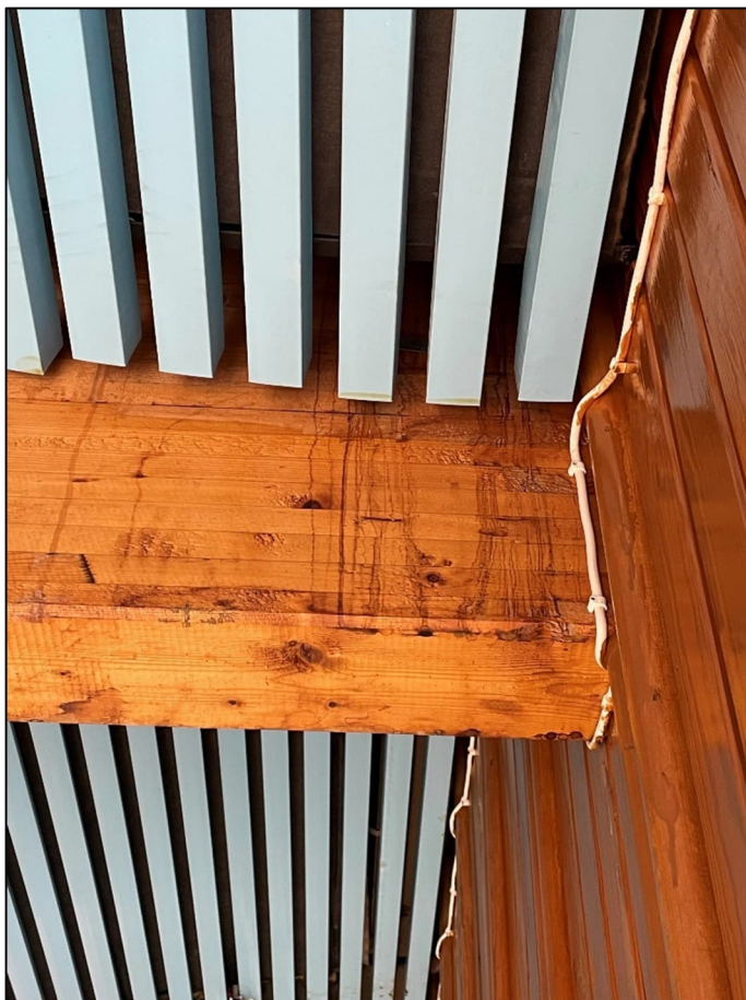
Figur 4.12. Exempel på fläckar utanpå limträbalk vid upplag, fasadvägg. (foto AFRY 2025-05-02).
