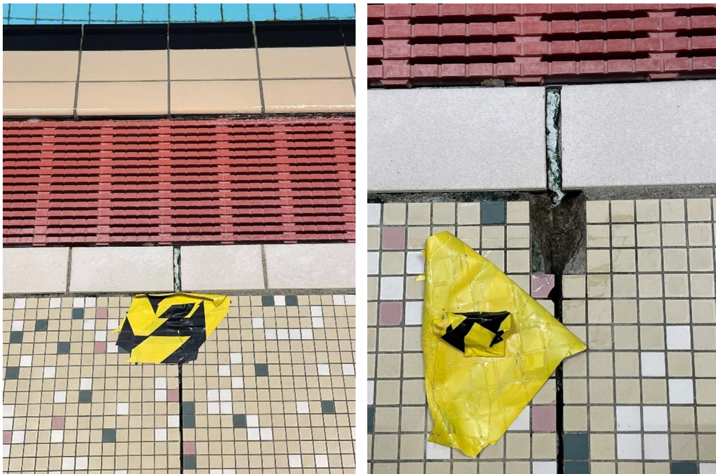
Figur 4.4. Exempel på kakelplattor som har lossnat från golv i simhall, (foto AFRY 2025-05-02).
