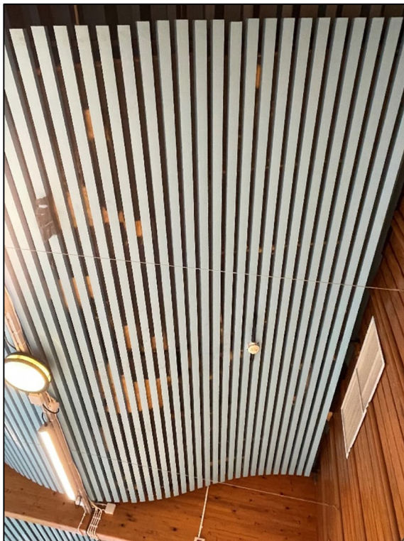
Figur 4.16 Exempel på isolering ovanpå undertak som har glidit till lägsta delen av undertaket, (foto AFRY 2025-05-02).
