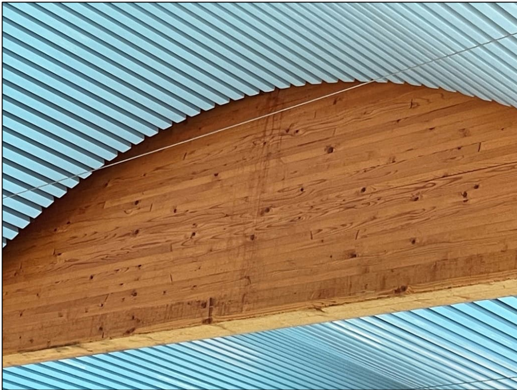
Figur 4.9. Exempel på fläckar utanpå limträbalk, mittparti av limträbalk, (foto AFRY 2025-05-02).
