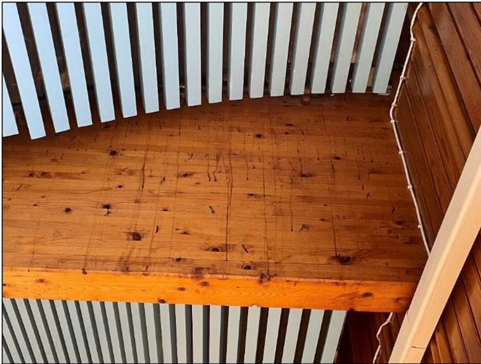
Figur 4.11. Exempel på fläckar utanpå limträbalk vid upplag, fasadvägg, (foto AFRY 2025-05-02).
