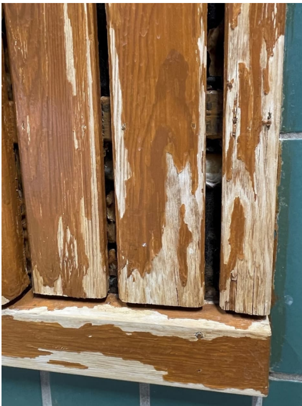
Figur 4.14. Väggbeklädnad – träpaneler monterade ca 600mm från överkant av golv i simhallen, färg har lossnats, (foto AFRY 2025-05-02).
