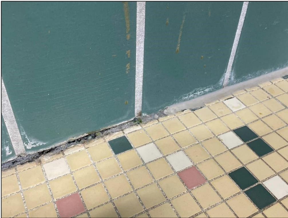
Figur 4.8. Exempel på skadad fog mellan golv och vägg, del av fog har reparerats, (foto AFRY 2025-05-02).
