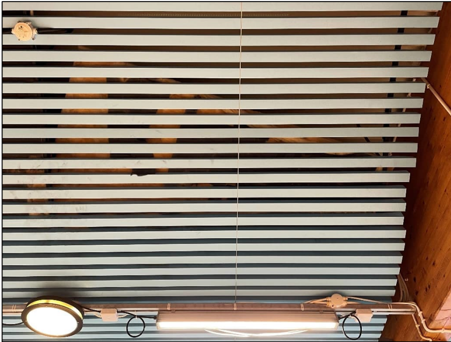
Figur 4.15. Exempel på isolering ovanpå undertak som har glidit till lägsta delen av undertaket, (foto AFRY 2025-05-02).
