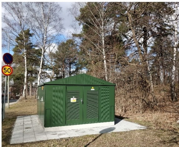
Elnätsstation vid Folkparksvägen som ges planstöd.
