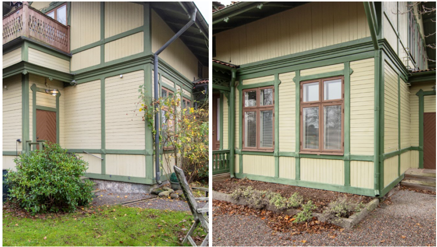
Bild till vänster: östra huset. Takvattnet leds till gräsyta för infiltration. Bild till höger: västra huset. Takvattnet leds till plantering och grusyta i anslutning till husgrunden.
