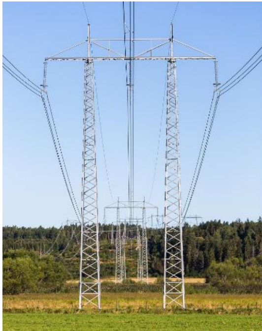
Figur 8. Exempel på en ostagad portalstolpe (B-stolpe) med två upphängda topplinor.
