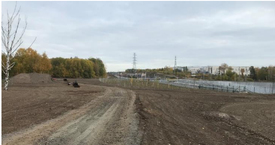
Figur 59. Hansta Hage under uppbyggnad (2022) och återplantering av gräs, buskar och träd efter Förbifartens entreprenad. Inom området anläggs även gång- och cykelbanor och en dagvattendamm/dike.
