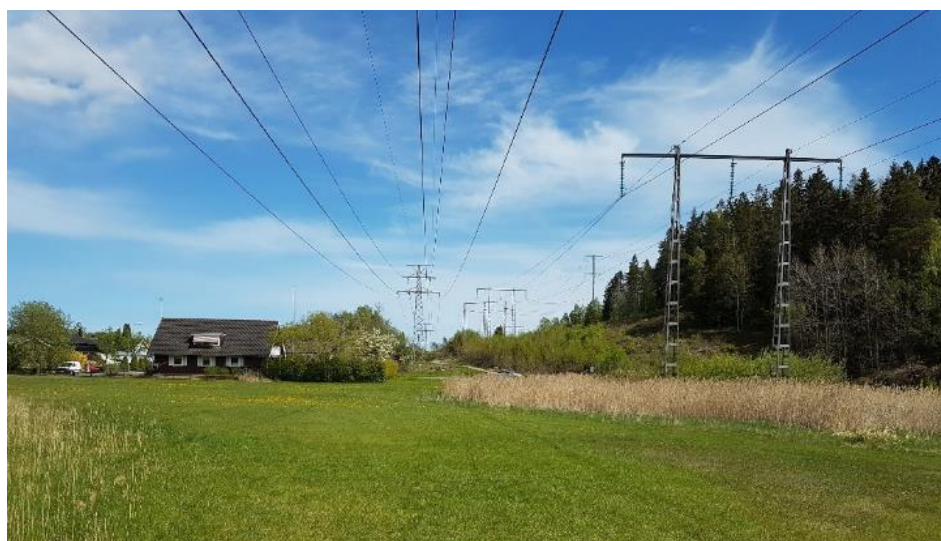
Figur 32. Befintlig ledningsgata vid Pommern med Vattenfalls sambyggda 70 kV-ledningar, Svenska kraftnäts 220 kV-ledning och Trafikverkets matarledning. 400 kV-ledningen planeras på den skogsklädda höjdryggen till höger i bild och Vattenfalls ledningar planeras på denna delsträcka att förläggas som markkabel. Vy mot öster.
