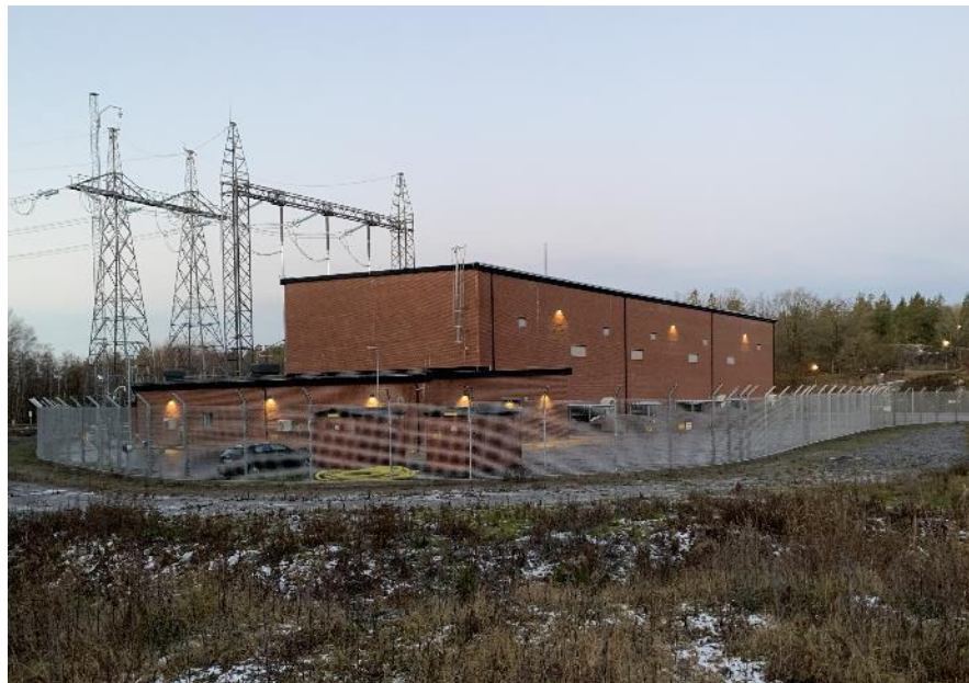
Figur 24. En befintlig inhägnad GIS-station med teknikbyte mellan luftledning och markkabel.
