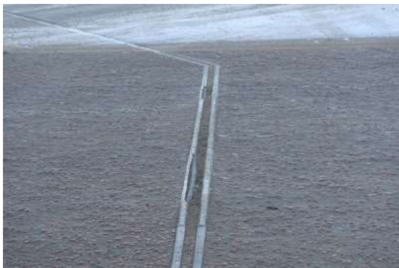
Figur 2. Fotografi som visar en nedsliten fogprofil med blottlagt gummi (november 2021).
