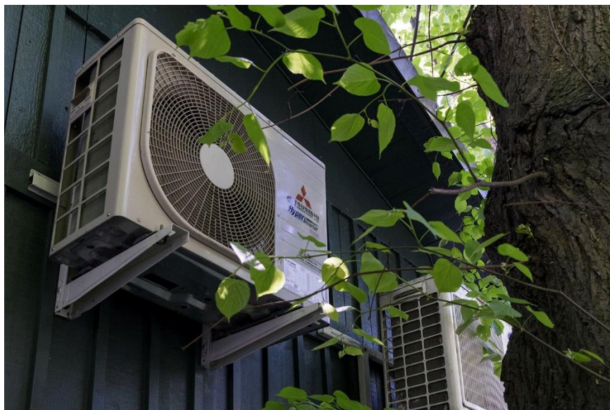
Luftvärmepump, Kronobergs Parklek, Kungsholmen
