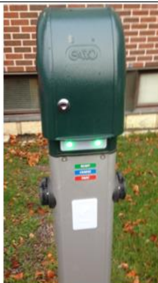
En laddstation med två laddningspunkter. Laddstationen sitter på ett fundament mellan två parkeringsplatser
