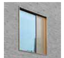
Fönster med tät plåtdel
