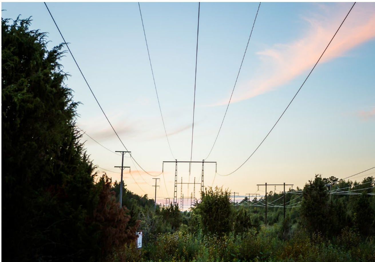
Figur 6. Befintliga ledningar och ledningsgata vid Viby, vy mot norr. Från vänster, Trafikverket 2x65 kV (JL7 S5), Svenska kraftnät 220 kV (KL22 S1-2) och Vattenfall 2x70 kV (ÄL81 S1 och ÄL86 S1).
