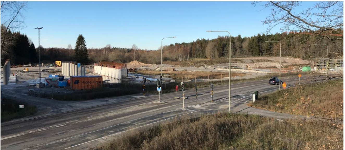
Figur 27. Vy not norr över Hästa klack och Akalla-länken med pågående arbete av Förbifart Stockholm.
