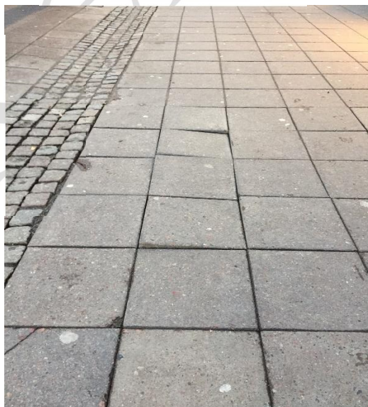
Figur 3. Plattor och gatsten kan innebära risk för fallolyckor på grund av ojämnheter och uppstickande kanter.
