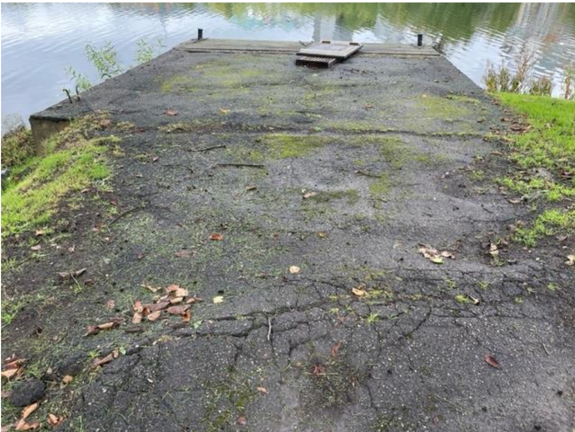
På den pålagda asfalten finns synliga skador med stora sprickbildningar med deformerade områden.
