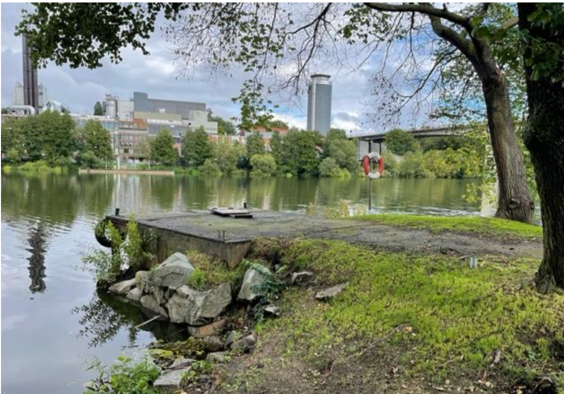
Gamla ångbåtsbryggan från Norrby Gård är i dåligt skick och behöver repareras och stabiliseras.
