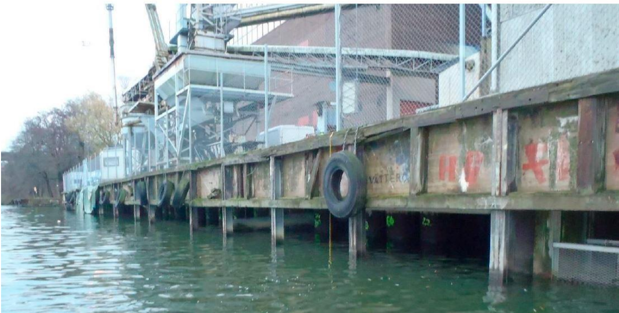
Foto av kajkonstruktionens skick mot Bällstaviken, ur utredning för översiktlig tillståndsbedömning av byggnadsverk kv. Gjutmästaren 6 och 9.
