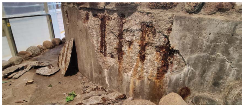
Bild 4. Allvarlig spjälkskada med stor utbredning på utsida vildforsens vägg.
