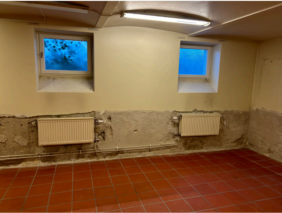
Det finns tecken på fuktskada i källaren, både på golv och väggar.
