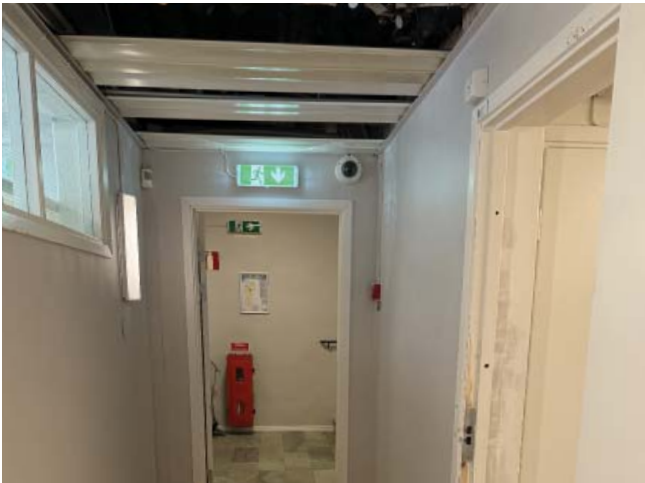
Undertak i korridorer är slitna och trasiga
