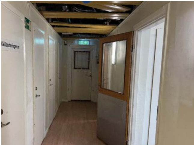
Väggar och golv är slitna och behöver rustas upp
