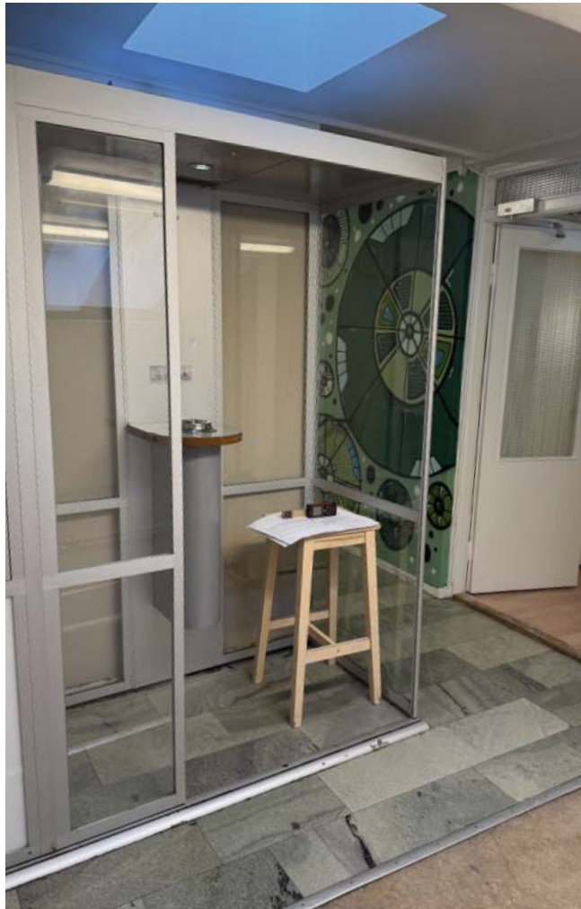
Befintligt rökbås i vägen för utrymningsväg
