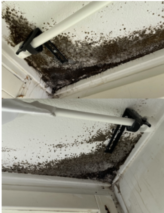
Mögelskada i tak vid fönsterparti.
