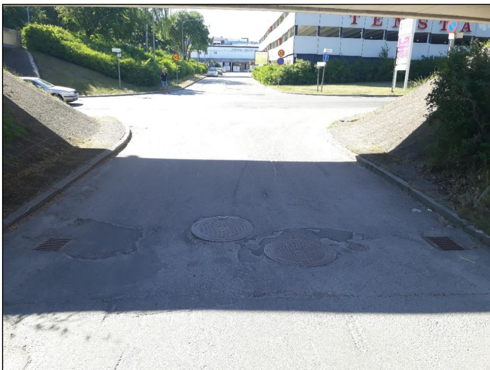
Figur 9. Rännstensbrunnar under gångbro (vy mot Tenstastråket)
