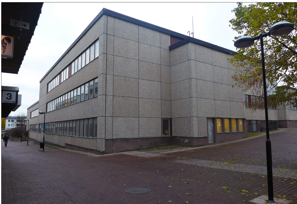
Hus A sett från sydöst. Hus A har ett markerat läge i hörnet och en tydlig horisontalitet. Fasaduttrycket, med prefabricerade betongelement med frilagd ballast av marmorkross, är tidstypiskt och karaktäriserar anläggningen.
