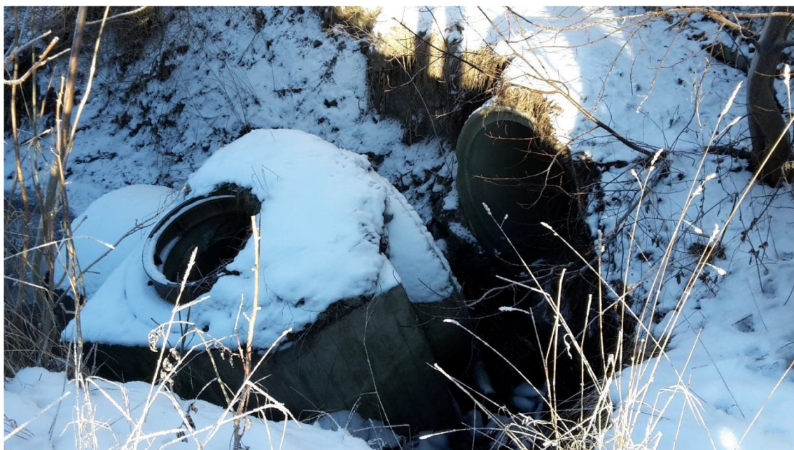
Foto 2. Anslutning av 1000 mm ledning vid dikets början, notera att brunn som tidigare varit ansluten för att ändra flödesriktningen har lossnat efter att omgivande mark eroderats bort.
