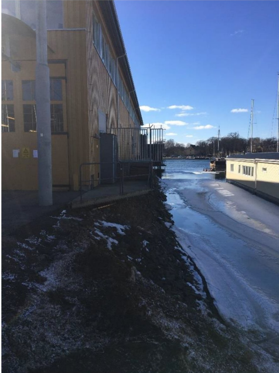
Spårvagnshallarnas norra långsida, med stuprör från tak som leder vatten direkt ut i Strömmen.
