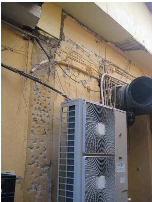
Utvändiga installationer i gränden mot norr. Delvis provisoriskt monterade och bristfälligt avslutade efter tidigare rivningsåtgärder.
