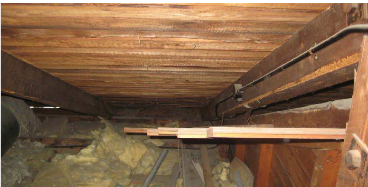
Exempel på takkonstruktion och yttertakspanel i tak över den tillbyggda delen. Kvarsittande barkrester förekommer som kan dölja mindre skadedjursangrepp.
