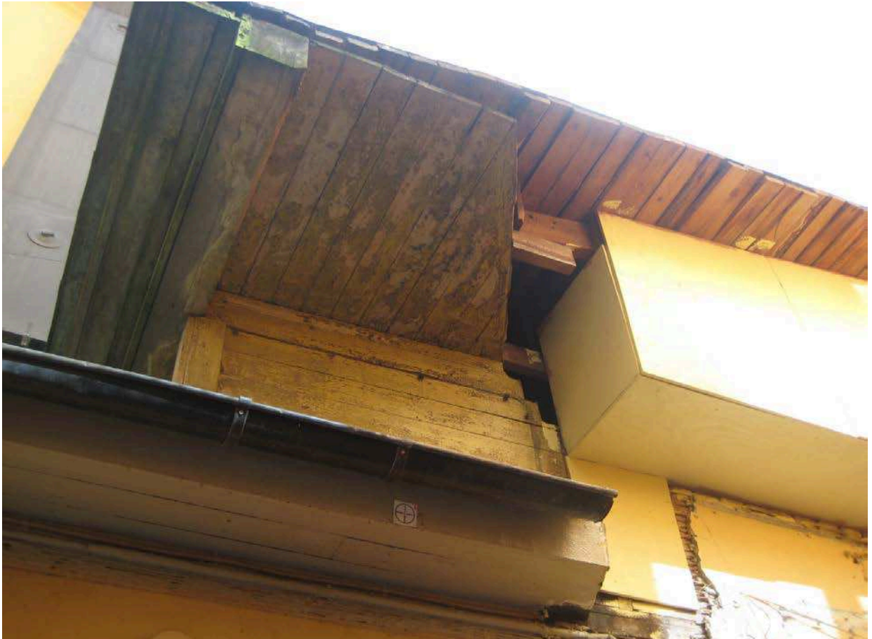
Del av kapad takkonstruktion mot gränden i norr. Behov av antändningsskydd och brandavskiljning mot grannfastigheten behöver utredas.
