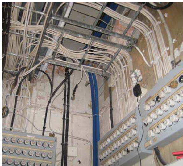
El-centraler i huvudbyggnadens bottenvåning. Omfattande dragningar av kablage där sannolikt delar tagna ur bruk eller provisoriskt anslutna i samband med tidigare genomförda rivningar.
