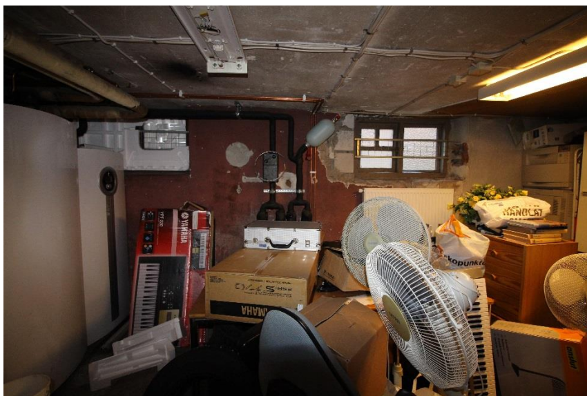
Pannrummet i källaren på Örbykyrkan. Foto januari 2018.
