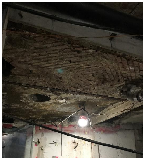
Fuktskadat valv i källaren.
