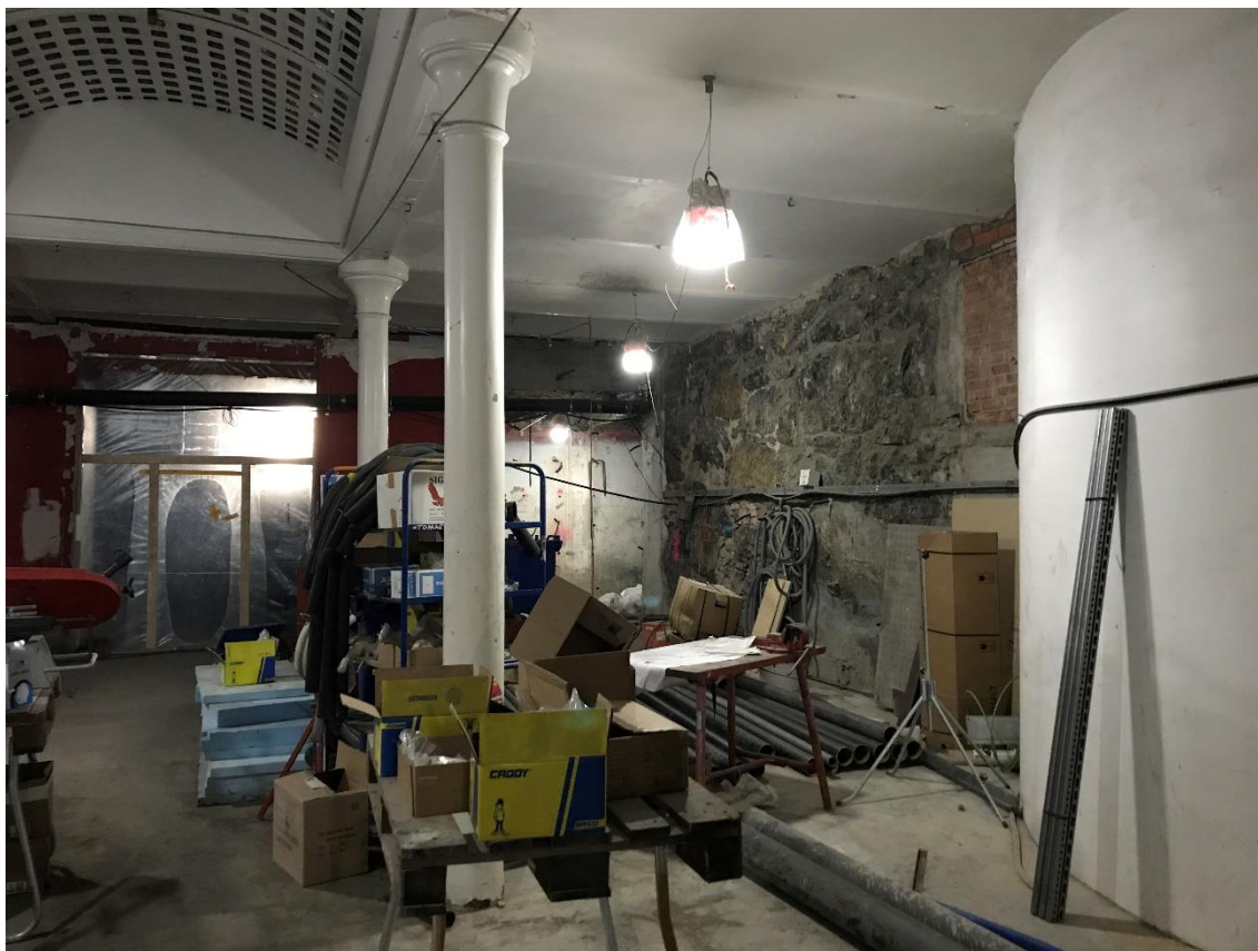
Källaren under gården med kolonner och galsbetongtak. I fonden källaren under kontorsdelen.
