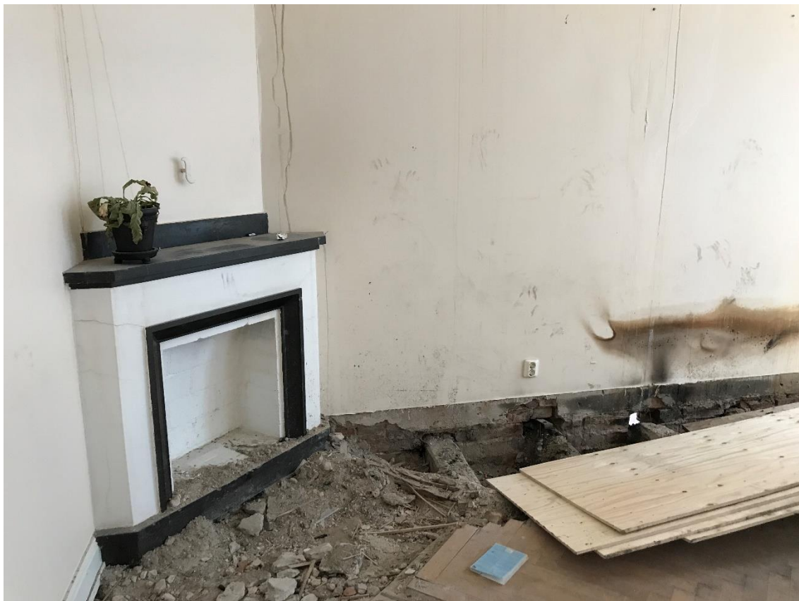
Bostadsrum vån 2 trappor med öppenspis från 1930-talet och samtida parkettgolv. Bjälkarna har vid branden börjat brinna inne i muren varför brandkåren brutit upp golvet för att kunna släcka.
