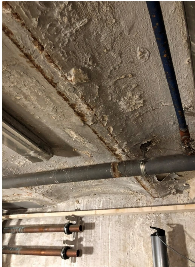
Figur 8: Rostanslag på valv under kontorsdelen. Bild tagen 2018-06-1
