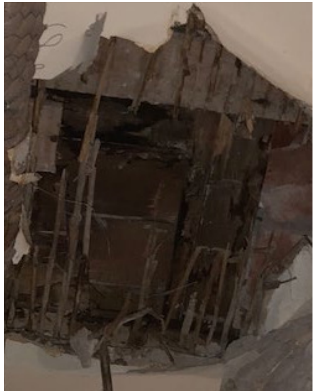
Golv, golvfyllning, innertak, bjälklagsfyllningar, ytterväggsmaterial samt brandväggar uppvisar mikrobiella skador. (Miljöinvent AB)
