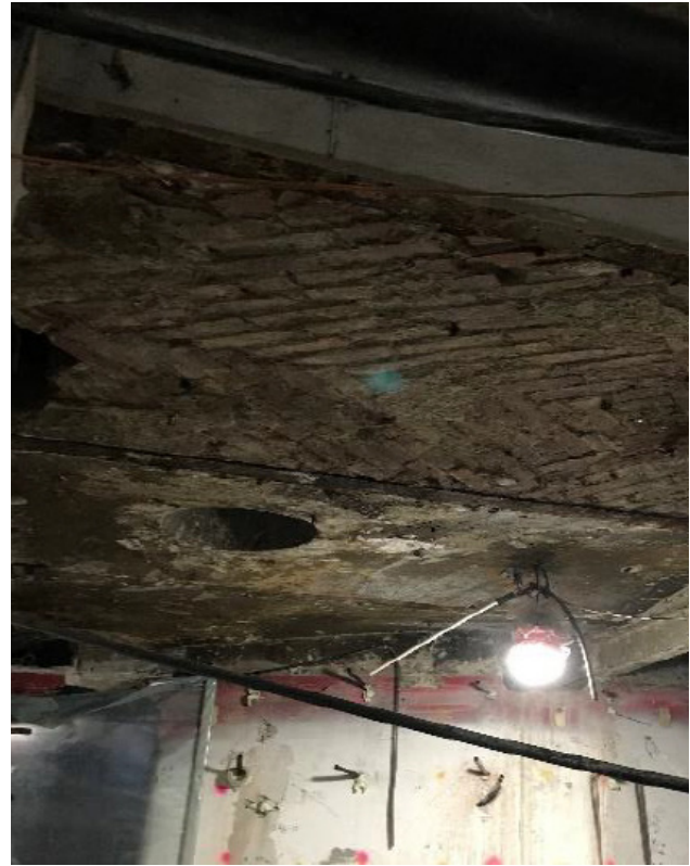
Fuktskadat valv i källaren. (AIX)
