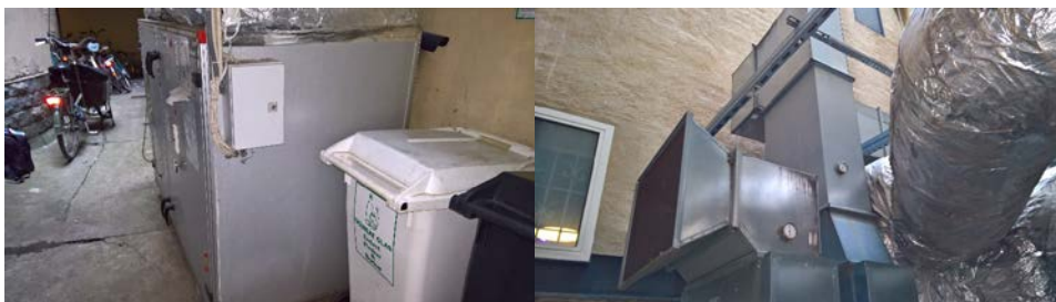
Figur 7 Fläktaggregat på innergård till Grev Turegatan 7B rivs i samband med ombyggnad.
