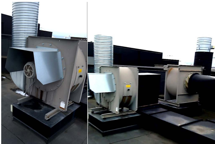
Figur 5 Radialfläktarna betjänar restaurangverksamhet i Sturegallerian. Båda fläktar utgår i samband med ombyggnaden.
