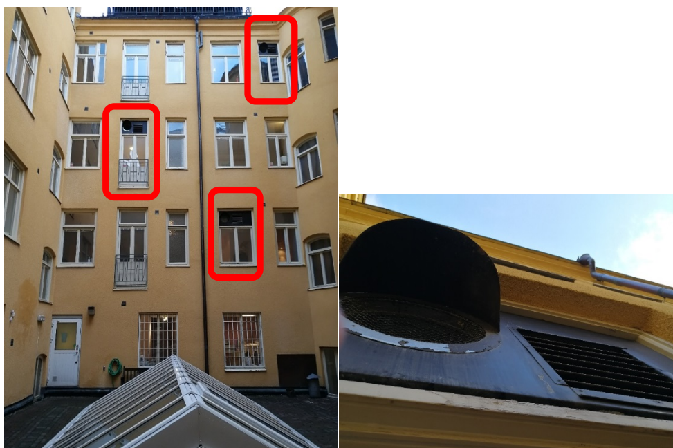
Figur 8 Avluftsutblås och uteluftsintag i fasad.
