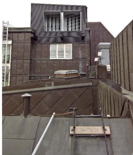
Figur 3 Fläktrummet på taket till Sturegatan 4C sett från söder. Denna källa rivs.
