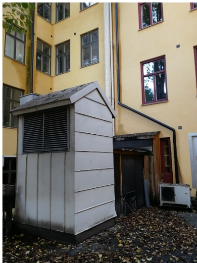
Figur 11 Installationer på innergård, Grev Turegatan 13. Till vänster syns kombihuvens som är i kontinuerlig drift. Till höger, en kylmedelkylare från Danfoss som aktiveras vid behov. Bakom kombihuvens finns ytterligare en kylmedelkylare, se nedan.
