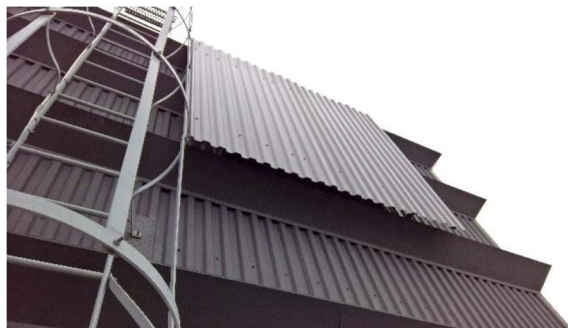
Figur 2 Fläktrummet ena mynning (mot norr) har försetts med en täckplåt, med höga ljudnivåer som följd. Denna källa rivs.
