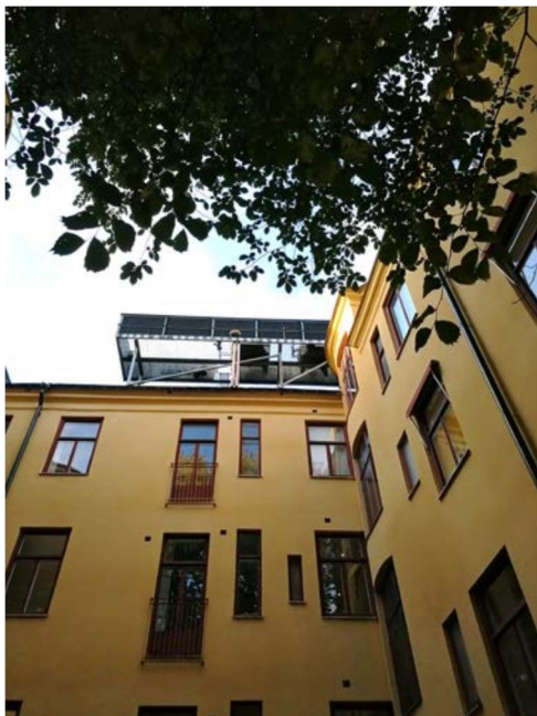
Figur 6 Kylmedelkylare på tak, Grev Turegatan 13. Ingen av kylarna kunde höras vid något av besökstillfällena. På grund av begränsad framkomlighet till taket var det ej möjligt att verifiera huruvida kylarna varit i normal drift eller ej. Kylarna flyttas eller rivs i samband med tillbyggnad.
