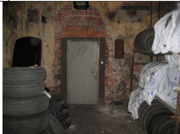
Förvaringsrum, i källaren, förorenat
