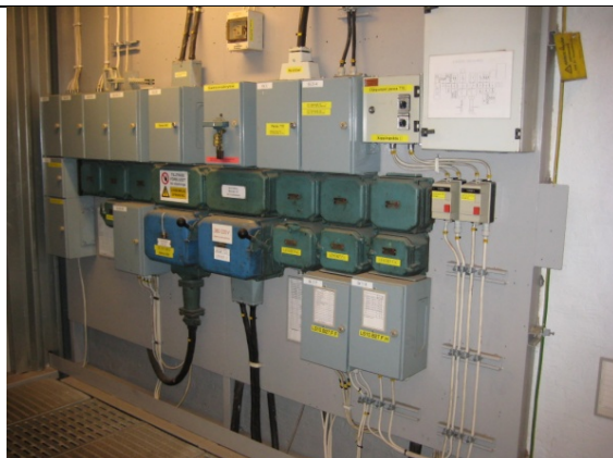
El/blandat nya och äldre installationer
