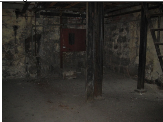
Utgrävd källare, förorenad
