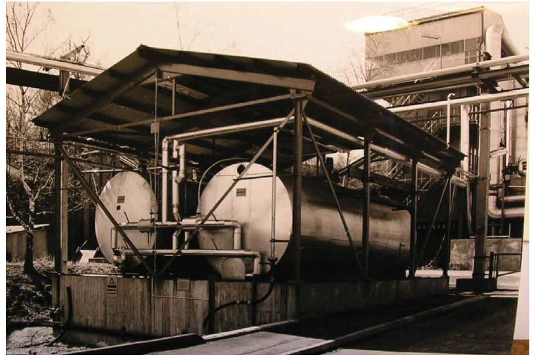
Lut- och saltsyrecisterner tidigt 1970-tal. Källa: gasverkets museum.
