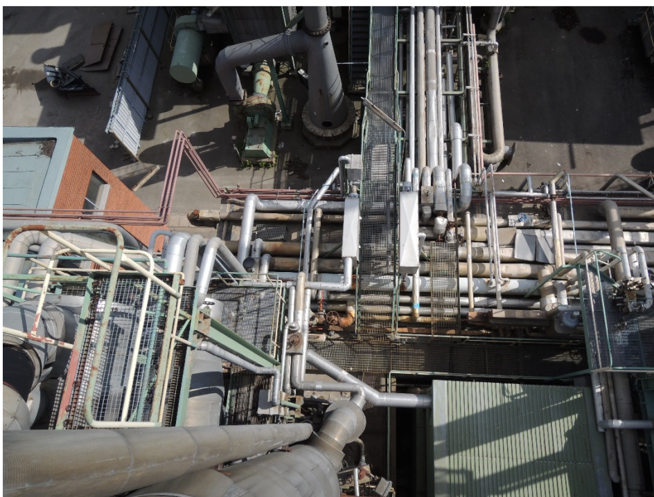
Rör sedda från kolsyrvatvätten.
