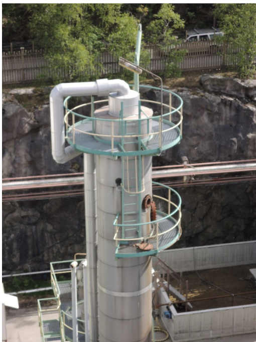
Torn med gångbanor.
