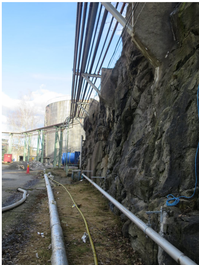
Vy 33. Södra ledningsstråket på konsoler längs bergsskärningen.
