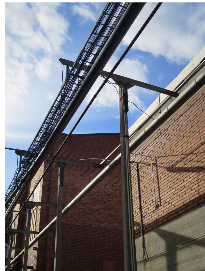
Vy 18. Norra ledningsstråket vid Ångkraftcentralen och Laboratoriet.
