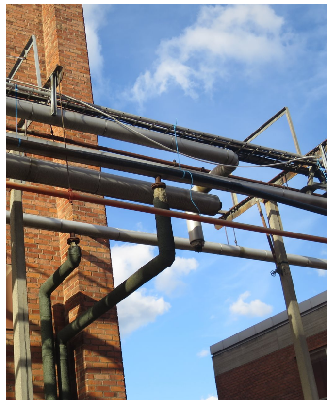
Vy 17. Norra ledningsstråket vid Ångkraftcentralen och Laboratoriet.
