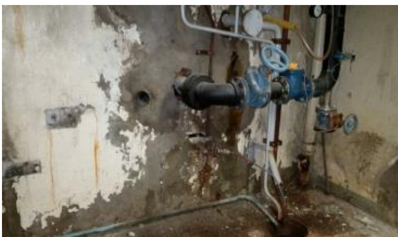
Bild 3. Rostsprängningar i källaren.
