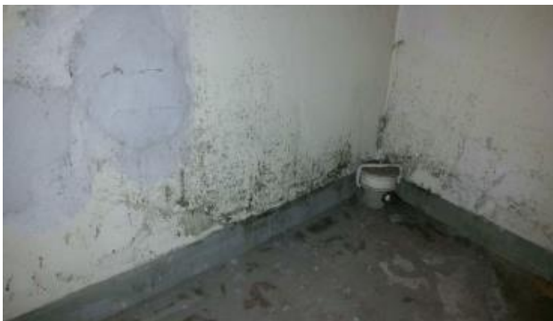
Bild 2. Påväxt på ytterväggar i källare
