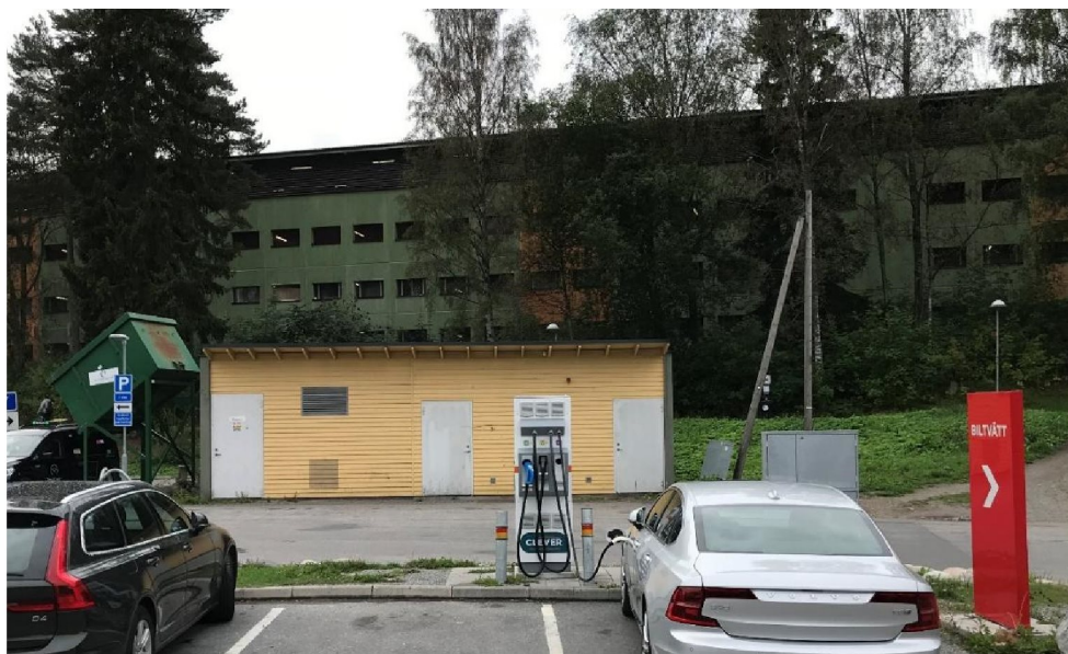
Figur 16: Befintlig laddstolpe för elbilar samt i bakgrunden byggnad innehållandes spillvattenpump, förråd samt nätstation.
