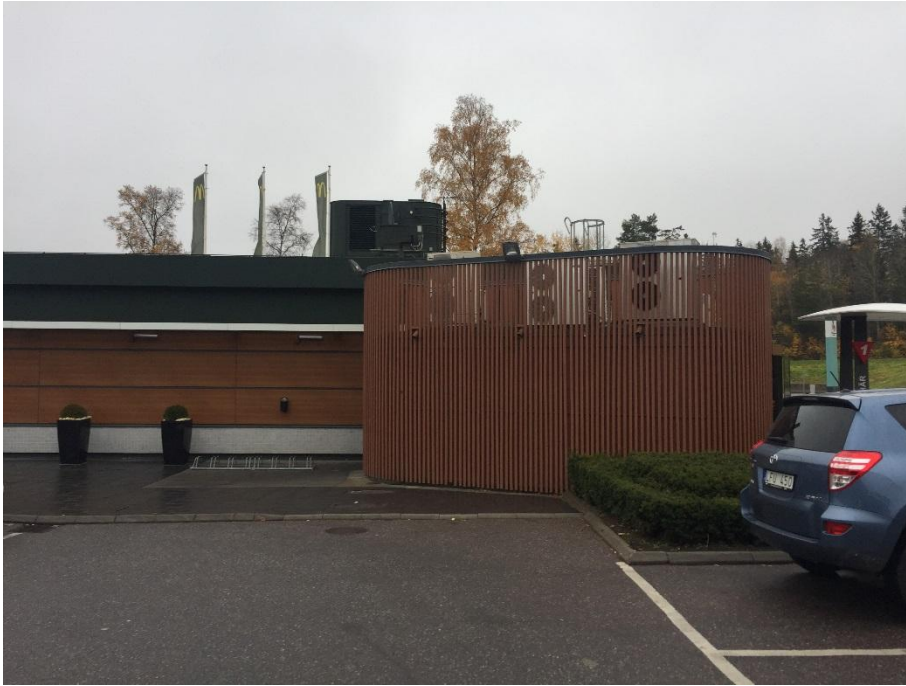
Figur 4. McDonalds har en större fläkt på taket och ett antal kylmedelskylare i en inbyggnad på gården. Fläkten har bara en mindre öppning åt fotbollsplanen. Kylmedelskylarna kan tänkas gå med högre fart på sommaren. Buller från McDonalds kommer inte påverka skolgården men lite buller påverkar skolans fasader som vetter år detta håll.
