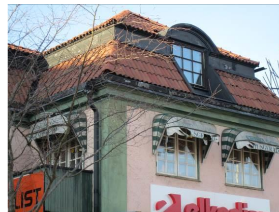
Takkupan i vinkeldelen har byggts om på 1930-talet och har fönstersnickerier från 1982.
