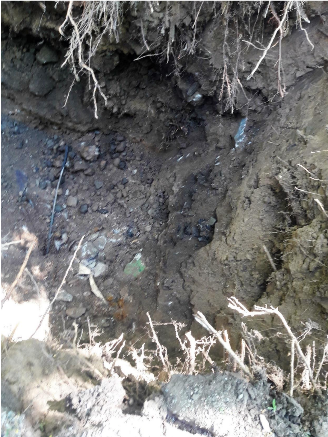
Bild 4: Schaktgrop med tjärasfaltsbitar och rivningsrester från provpunkt 19W01, ca. 0,8 – 1,7 m u my.
