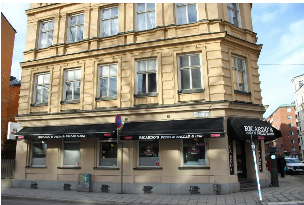
Entréväningens ursprungliga putsrelief har förenklats vid tidigare fasadrenoveringar. Samtliga fönster är utbytta, sannolikt på 1970-talet.
