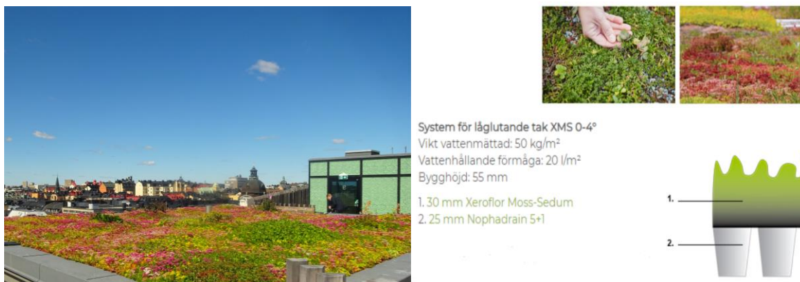
Figur 10. Sveavägen 44, grönt sedum-tak med pimpstensjord tjocklek 8–10 cm. (foto: Bara Mineraler) Samt möjlig uppbyggnad (illustration: Vegtech)
