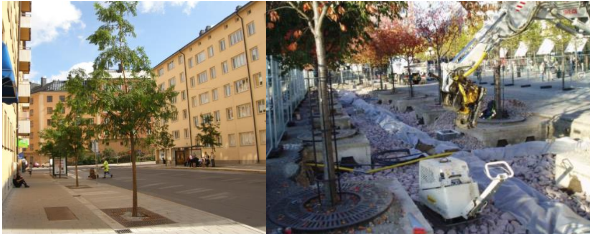
Figur 13. Exempel på område med träd i skelettjord i gatumiljö (Stockholm vatten och avfall, 2018)
