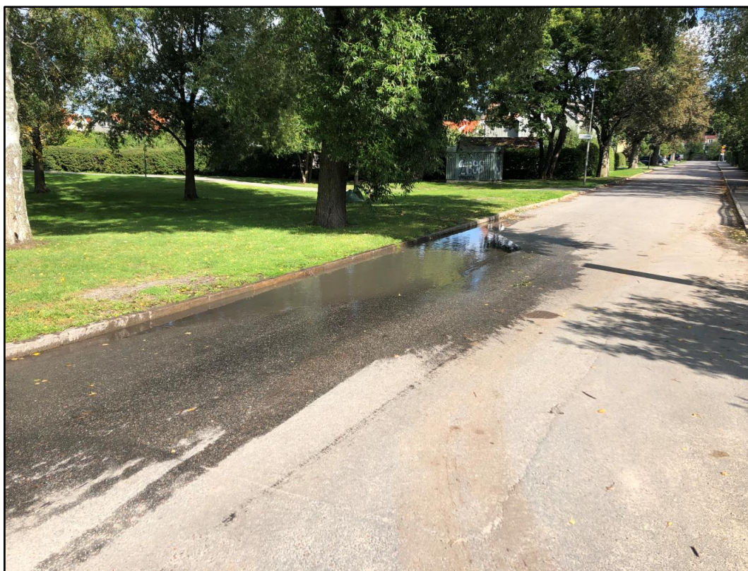
Figur 7. Foto taget 2019-09-12 på Ålandsvägen i nordlig riktning. Visar att dagvatten kan ansamlas längs med kantstenen.
