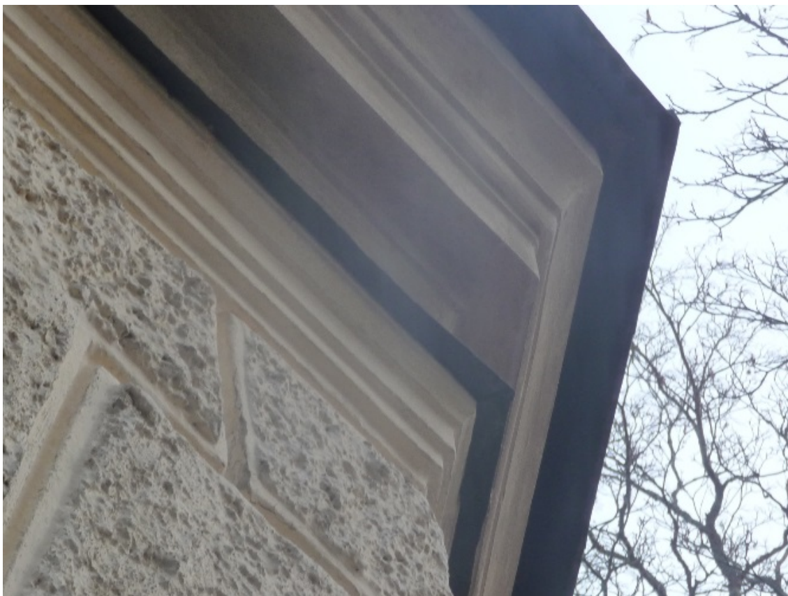
Takfot med plåtlist, extra luftning av kupoltak?
