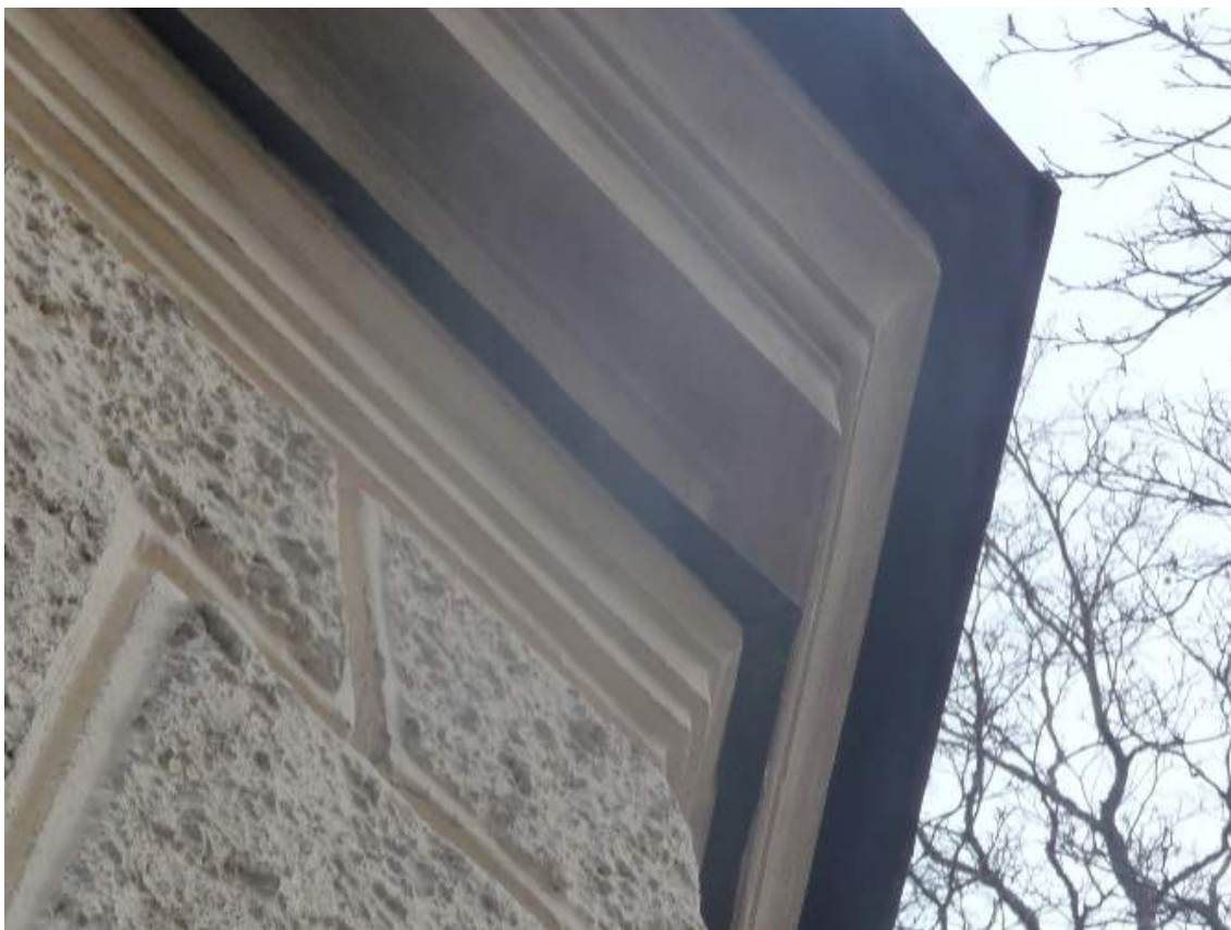
Takfot med plåtlist, extra luftning av kupoltak?
