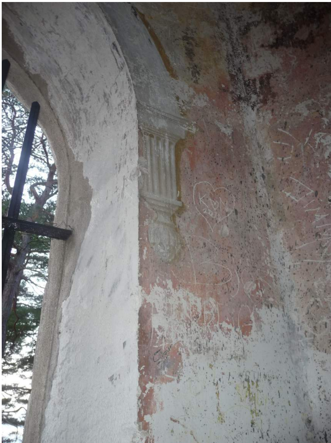
Dekormålning runt öppning i marmorimitation som delvis är välbevarad. Putsytorna har även sentida klotter inristat i väggytorna.
